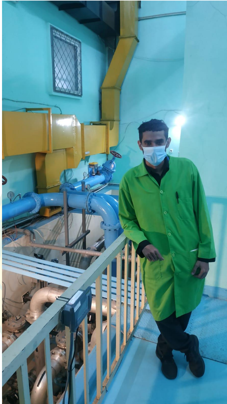
Gambar A. 1 Dokumentasi sebelum dilakukan pengujian pompa primer
