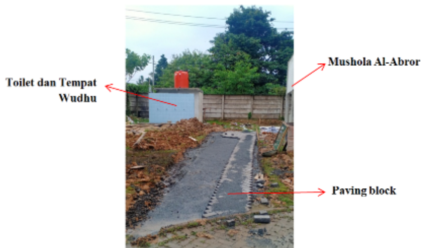
Gambar 2. Pembangunan Jalan Setapak Menuju Tempat Wudhu dan Mushola Al-Abror Sumber: Dokumentasi, Januari 2021
