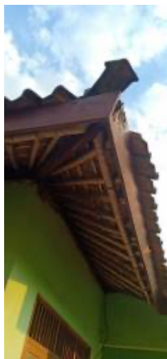
Gambar 5. Papan Lisplang dan Genteng yang Rusak pada Sisi Jurai Atap (Sumber: Dokumentasi, Juli 2019)
