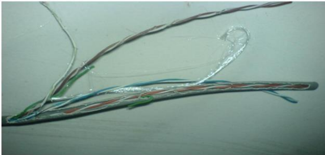
Gambar 4.3. Kondisi Kabel UTP
