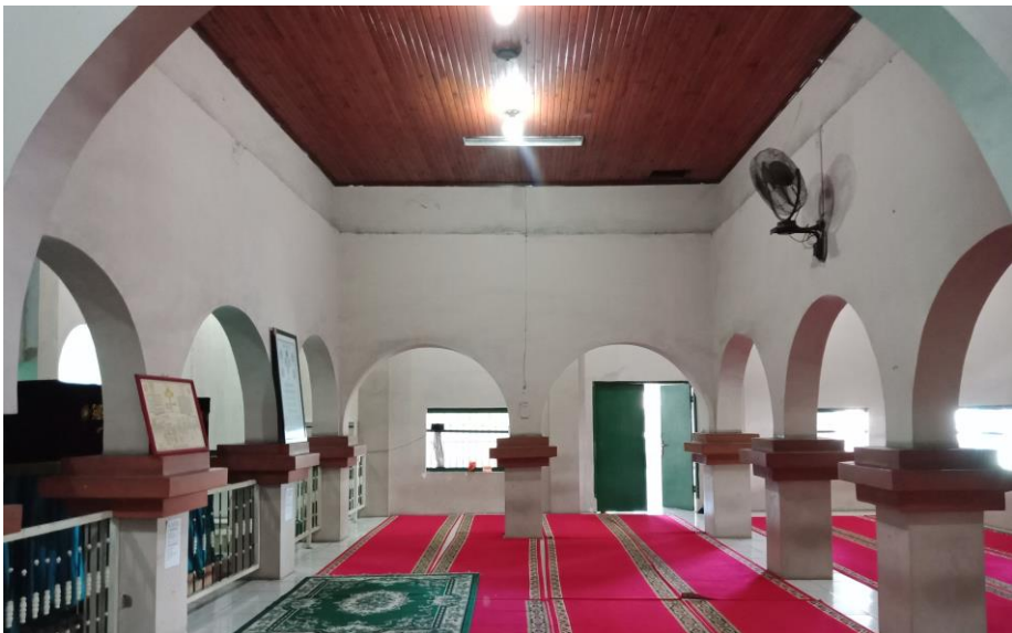
Gambar 5.106 Ruang Utama Bangunan Lama Masjid Al Mukarromah Kampung Bandan. Tempat sebelah kiri adalah area makam. [Dokumentasi Penulis, 2018].
