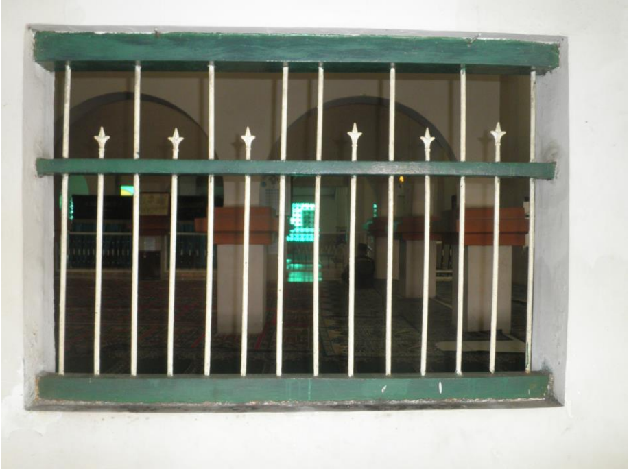
Gambar 5.111 Detail Jendela Pada Bangunan Lama Masjid Al Mukarromah. Terlihat Jalusi besi bulat yang runcing ujungnya.[Dokumentasi Penulis, 2018].
