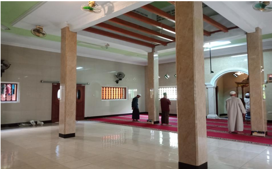
Gambar 4.34 Saka Guru Masjid Al Anshor, Bangunan Lama, yang sudah diganti kolom beton. [Dokumentasi Penulis, 2018].
