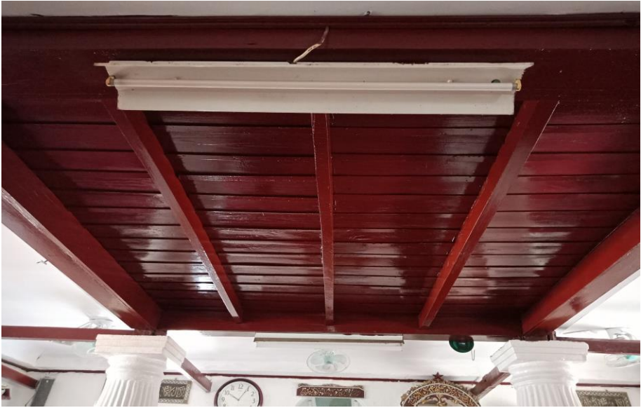
Gambar 4.16 Bagian atas di antara empat pilar pada Ruang Dalam Masjid Al Alam Marunda ditutup dengan konstruksi papan. [Dokumentasi Penulis, 2018].
