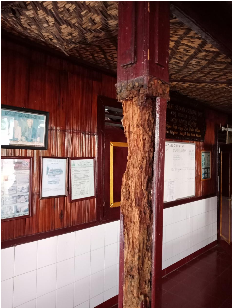
Gambar 3.11 Salah Satu Tiang Teras Sisi Timur Masjid Al Alam Cilincing, Bangunan Lama; yang sudah dalam keadaan krops. [Dokumentasi Penulis, 2018].
