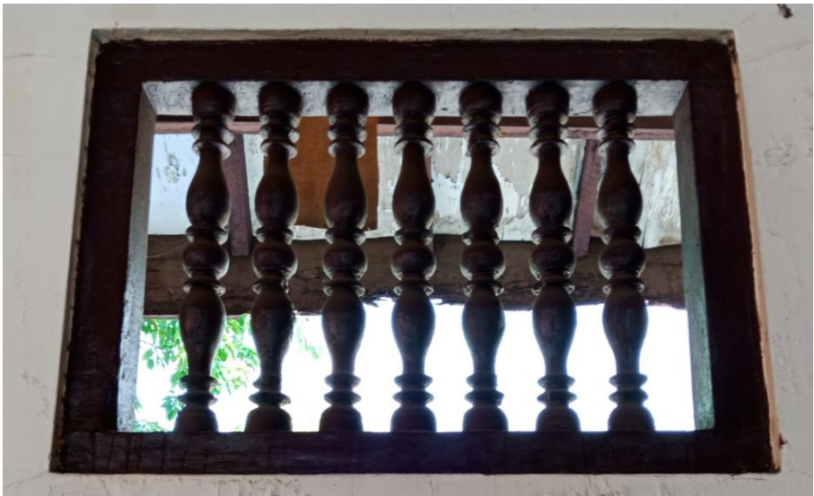
Gambar 6.24 Detail Bentuk dan Konstruksi Jendela Masjid Langgar Tinggi; khas Betawi. [Dokumentasi Penulis, 2018].
