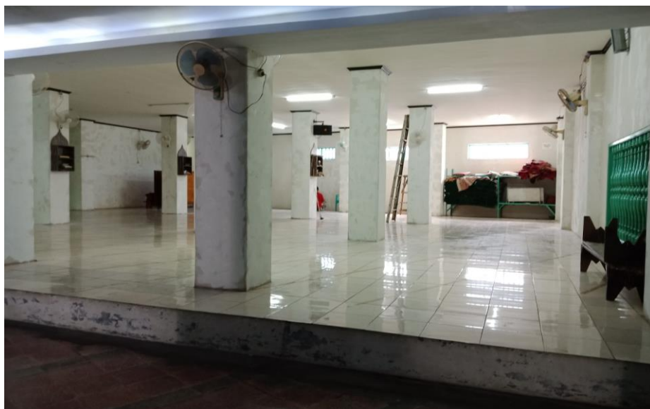
Gambar 5.24 Serambi Utara Masjid Al Mansyur. Terdapat perbedaan peil lantai antara lantai serambi utara dan lantai ruang utama, sekitar 30 cm. [Dokumentasi Penulis, 2018].
