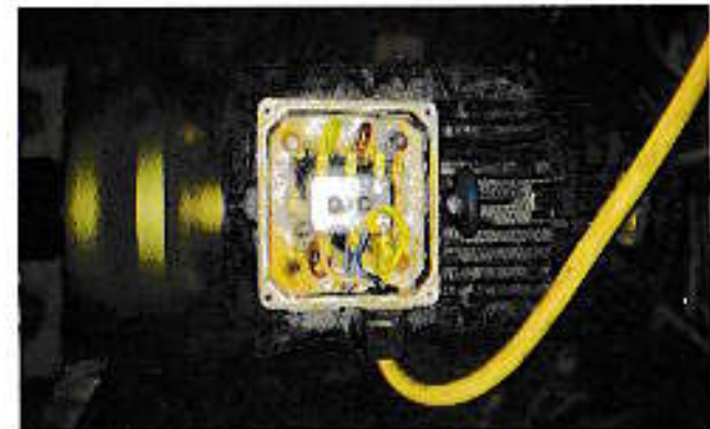
Gambar 10. Catu Daya Pompa Air Tiga Fasa
