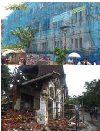
Gambar 9 dan 10: Beberapa gedung di Kota Tua yang telah roboh dan direkonstruksi
