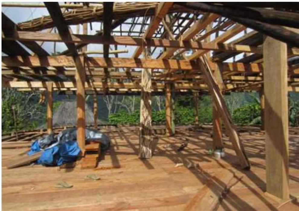
Gambar 9,10: Proses restorasi Mbaru Niang di Desa Waerebo, Flores (Sumber: https://bandanaku.wordpress.com , diakses 08 Mei 2017)
