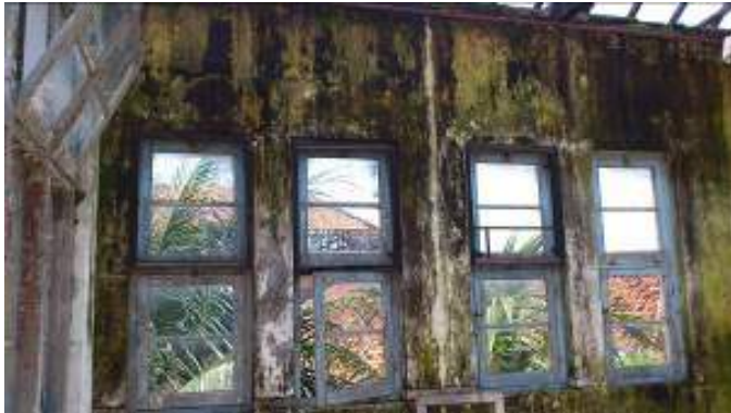
Gambar 2. Lantai 3 Gedung PT PPI, yang sudah tidak beratap Sumber: Dokumentasi Pribadi, 2015
