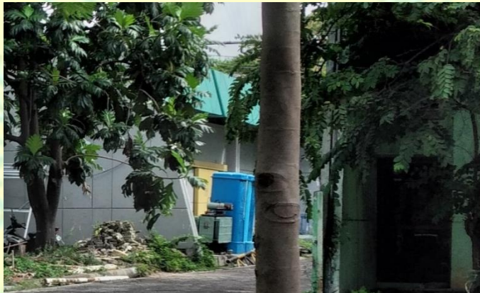
Gambar 2.22 Gardu Listrik dan Genset Kantor Unit PT. KBN Cakung (Sumber : Pribadi)
