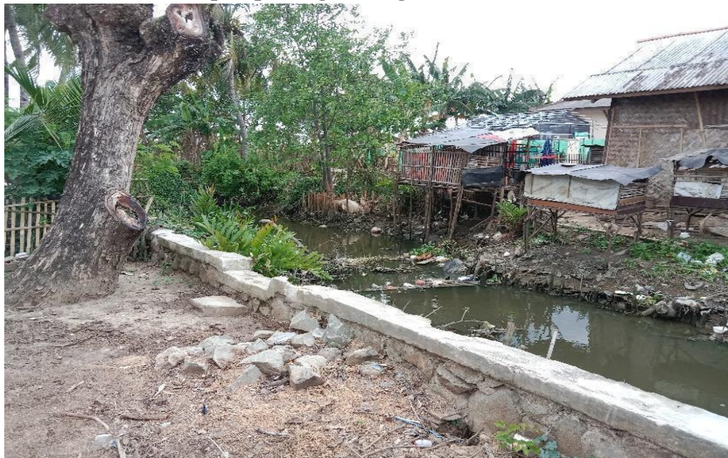
Gambar 4. 6. Turap Tepi Sungai Mengalami Kerusakan
