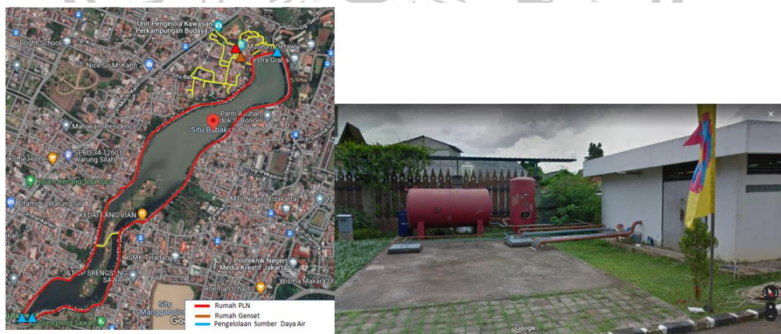
Gambar 4.40 Jaringan Listrik Genset
